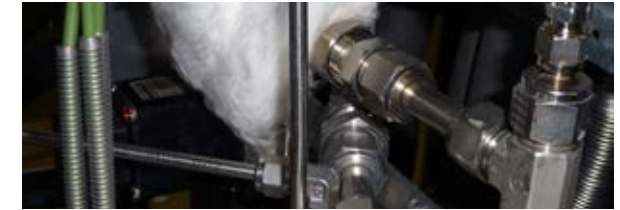
Detailansicht eines Erdgas-Reformers für BZ-Systeme
